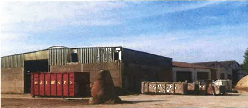
DeelRUP 1: zicht op achterzijde (deels) te slopen loodsen in zuidelijk deel bedrijfssite
